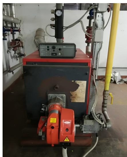
Figura 8.9 - Particolare del generatore di calore attuale
