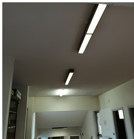
Figura 4.14 - Particolare dei corpi illuminanti ubicati nei locali dell'edificio
