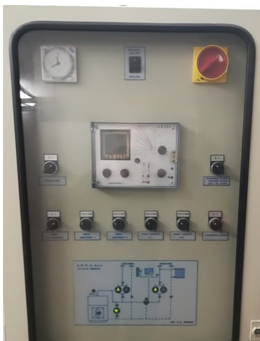
Figura 4.8 - Particolare del pannello di controllo di dell'impianto termico
