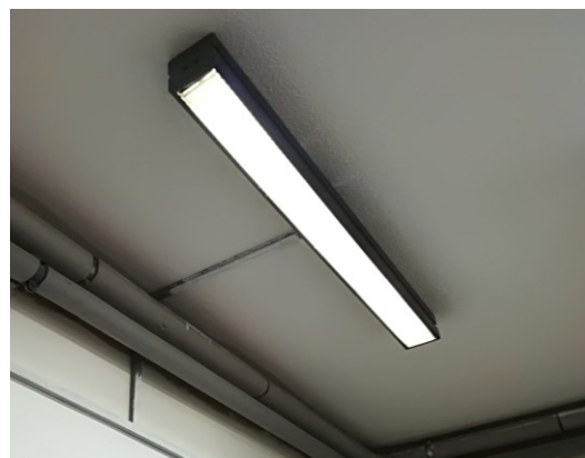
Figura 8.12 - Particolare di una lampada fluorescente attualmente installata
